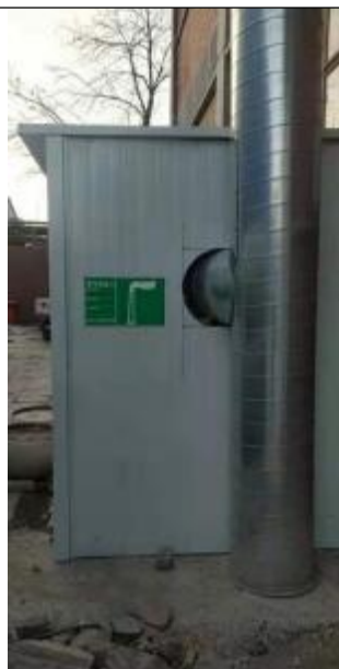
排气筒 P1 标识牌
