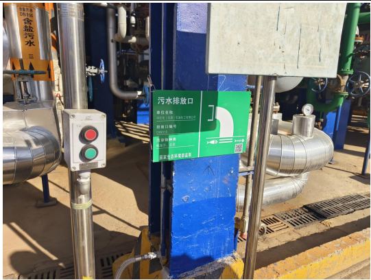
2#常减压装置电脱盐废水排口
