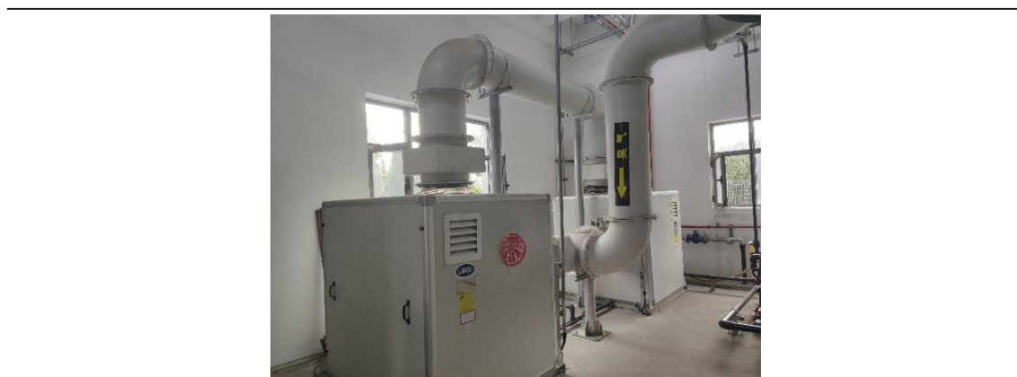
污水处理中心除臭系统
