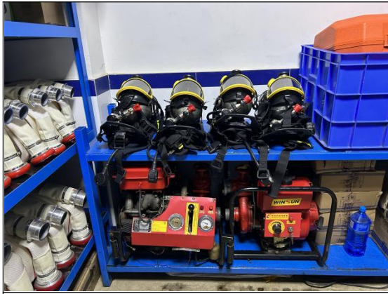
消防手抬泵机组
