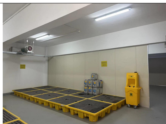
危险废物暂存间托盘
