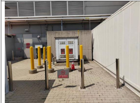
天然气调压柜
