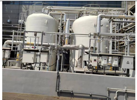
废水收集罐IW罐及围堰
