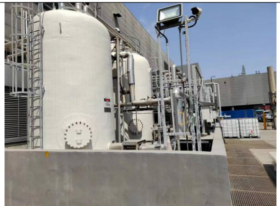
废水收集罐IW罐
