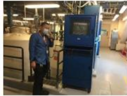
现场人员立即拨打6666报告现场情况
