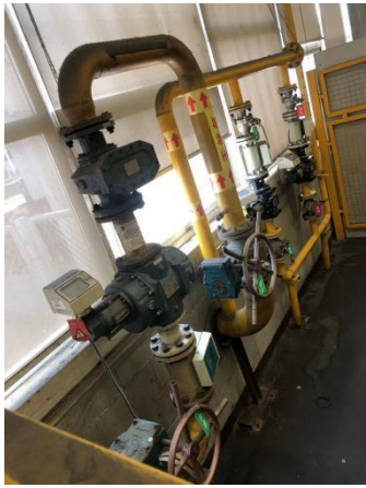
车间内天然气总进气管道阀门
