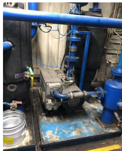
VPI储罐区真空泵及托盘
