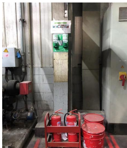
VIP储罐间灭火器，洗眼器，消防沙
