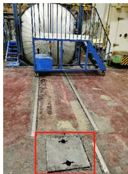
浸渍罐清洗废液收集桶（地下）
