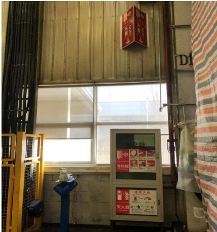
B01车间内消防栓
