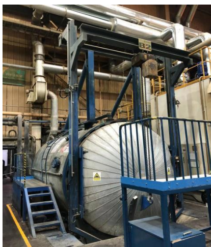
B2 浸渍罐，双层罐，罐体下面为地坑
