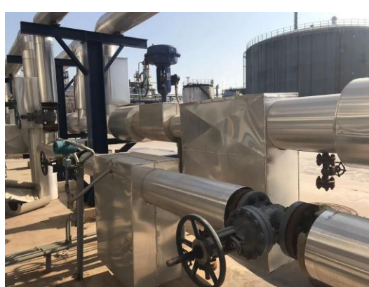
产品调合管道系统阀门法兰密封照片
