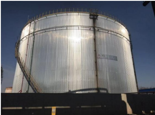
加氢渣油储罐2（固定顶罐）
