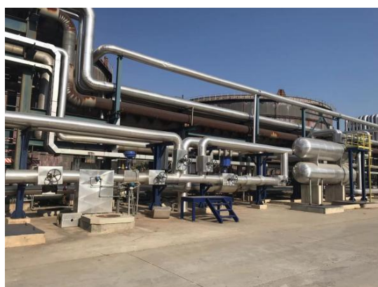
产品调合管道系统
