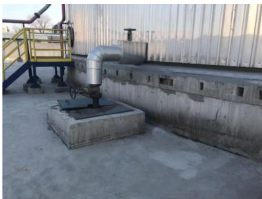
加氢渣油储罐阀门密封照片
