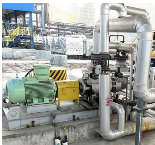
加氢渣油调合泵（新建）
