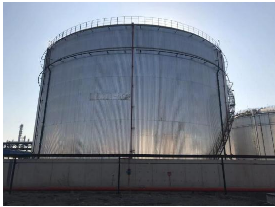
加氢渣油储罐1（固定顶罐）
