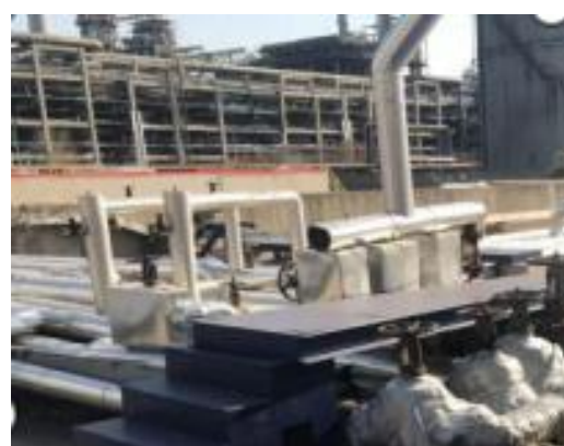
催化油浆罐区阀门法兰密封照片
