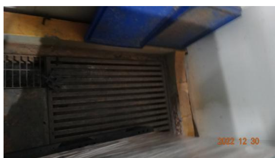
废电池存储区泄漏槽及收集池
