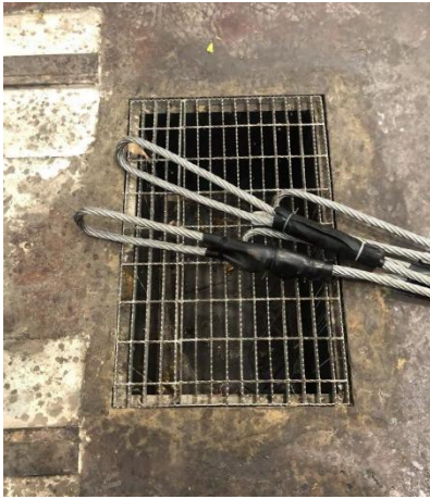
VPI 间泄漏收集池
