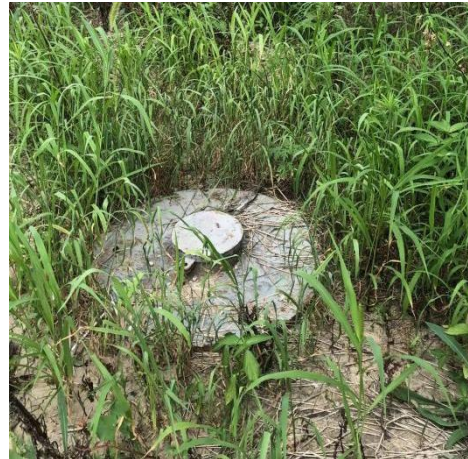
危废间化学品库连接的泄漏收集池
