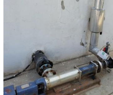
事故池提升泵
