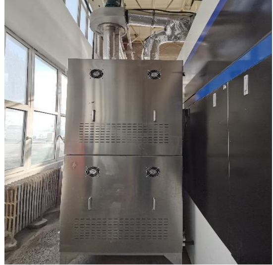
浸渍工序UV+活性炭处理设备
