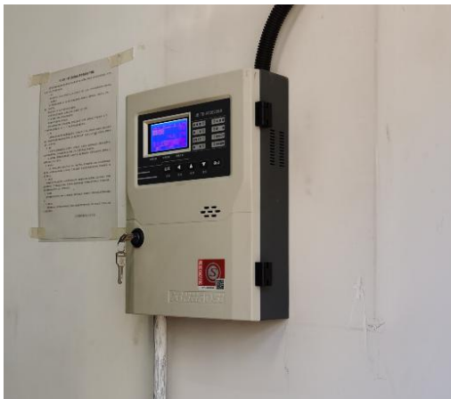
锅炉房天然气电磁阀报警装置
