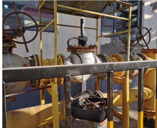
锅炉房天然气管道电磁阀手动阀
