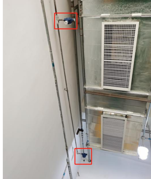
锅炉房燃气泄漏报警器
