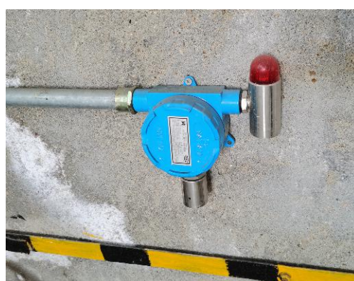
甲醇间泄漏报警器
