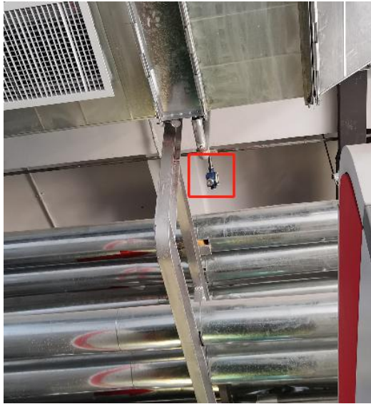
锅炉房燃气泄漏报警器
