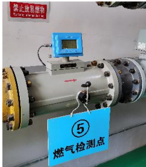
锅炉房燃气检测点
