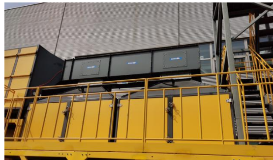
浸渍废气处理设备(活性炭吸附脱附+催化燃烧)
