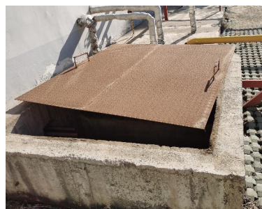
柴油库应急收集池
