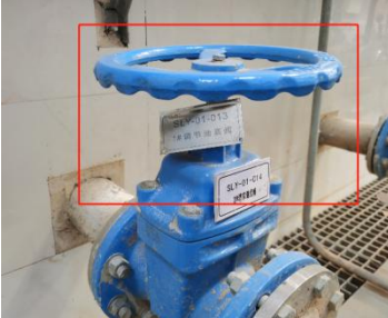
渗滤液处理池泵房手动阀门
