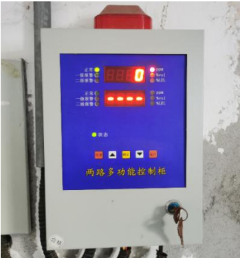
氨泄漏报警装置
