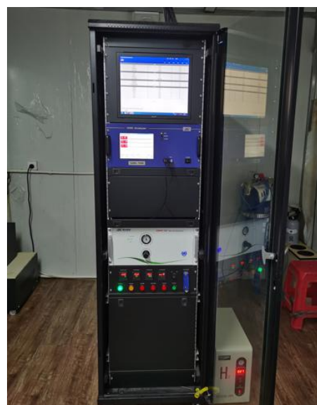
废气在线监控系统
