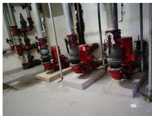
消防水池及水泵
