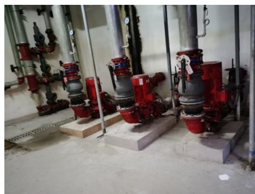
消防水池及水泵
