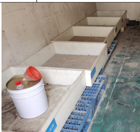
化学品库防渗漏托盘
