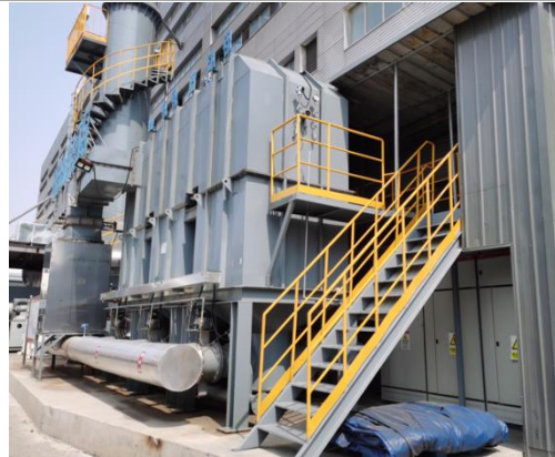
新增的沸石转轮+RTO 处理设备
