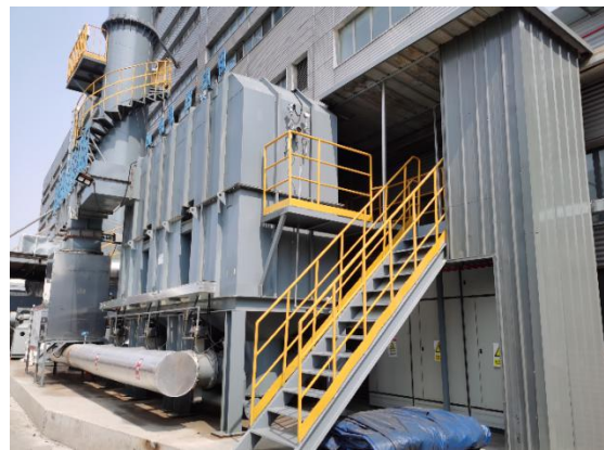
沸石转轮吸附脱附+蓄热式燃烧RTO
