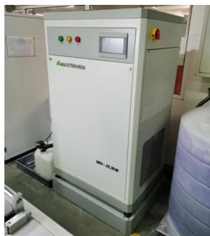
A楼一层废显影液处理系统
