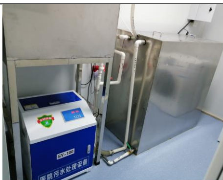
图 3-2 污水处理设备
