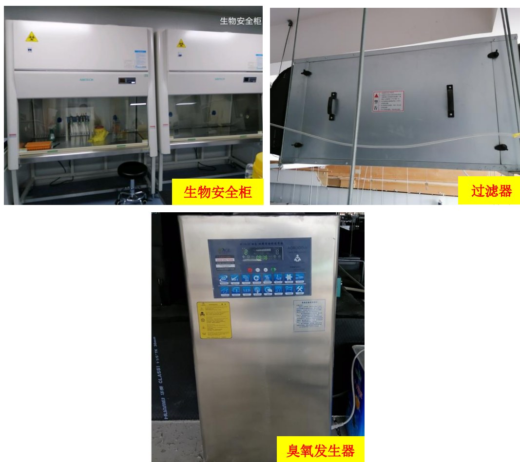
图 3-1 废气处理设施
