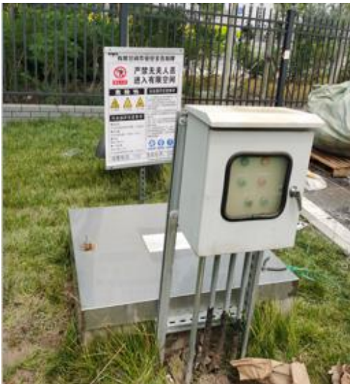
厂区西北侧雨水收集池
