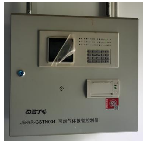
应急发电机房可燃气体报警器
