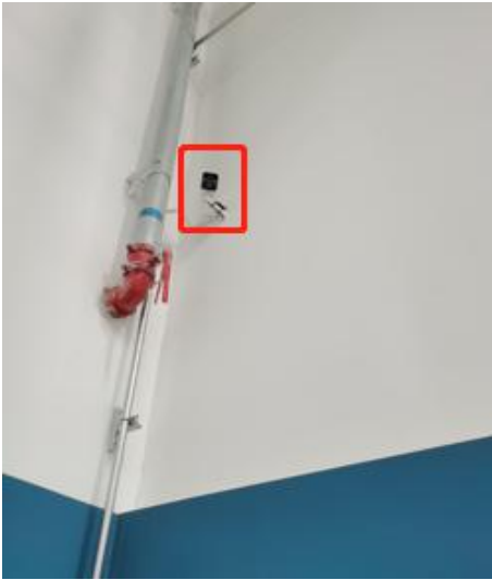
原料存放间摄像头
