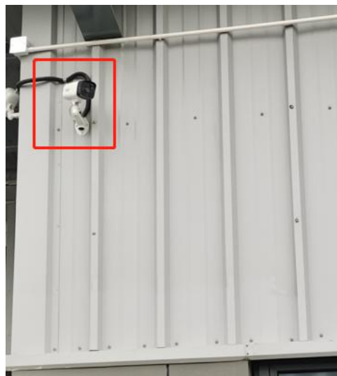
危废暂存间摄像头
