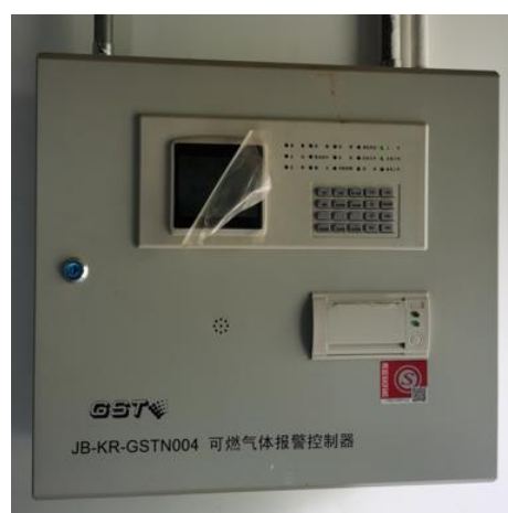
应急发电机房可燃气体报警器
