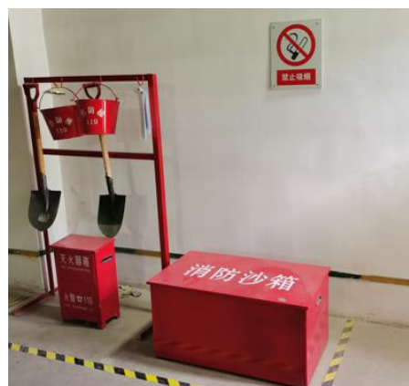
消防沙及收集设施
