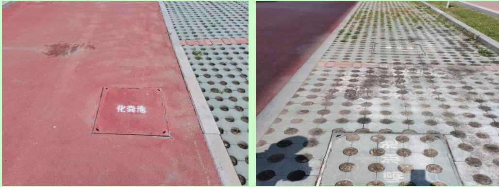
图 4-7 化粪池和隔油池
