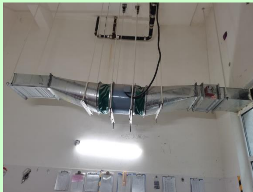
图 4-6 地下车库送风机
