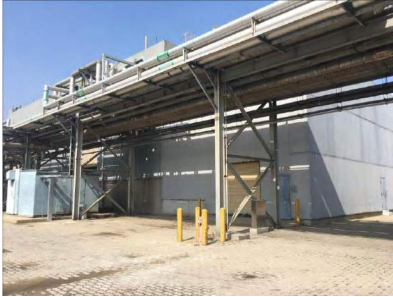
图 1.3-9 中芯国际污水处理站照片
