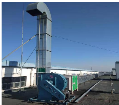
图 3-2 P1 排气筒及收集管道图
