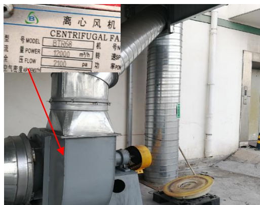
图 3-8 P3 废气净化设施风机及排气筒
