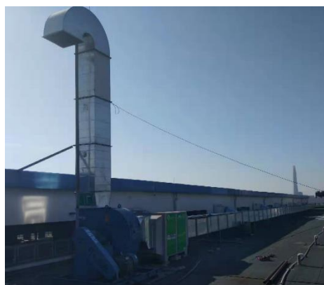
图 3-3 P2 排气筒及收集管道图
