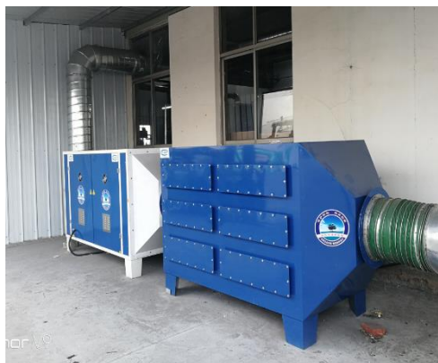
图 3-7 印刷车间光氧+活性炭处理装置
