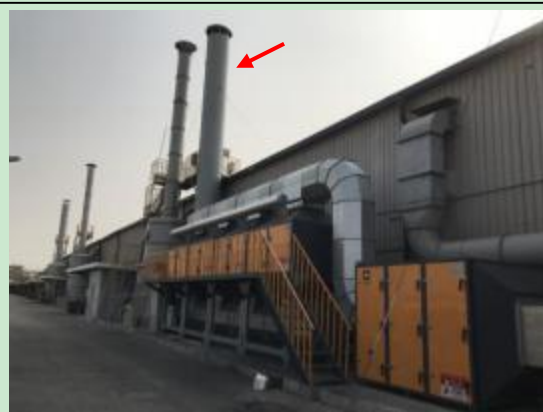
图 5 有机废气治理设施及排气筒
