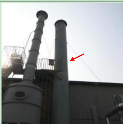
图 7 有机废气排气筒采样平台
