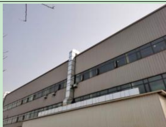
图 3 滤筒除尘器排气筒
