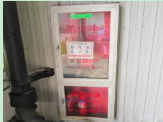
图 6 生产区配置灭火器等消防设施
