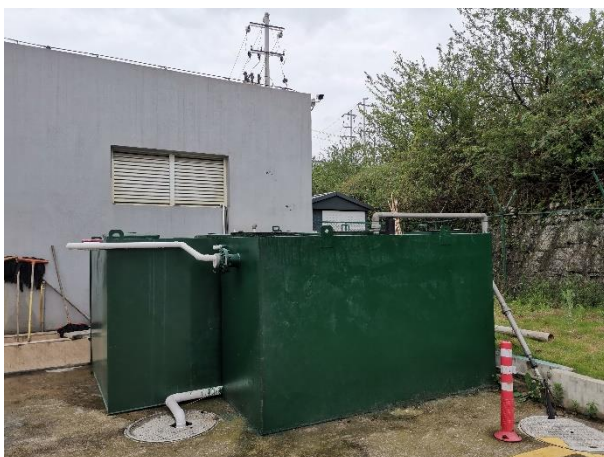
一体化处理设施
