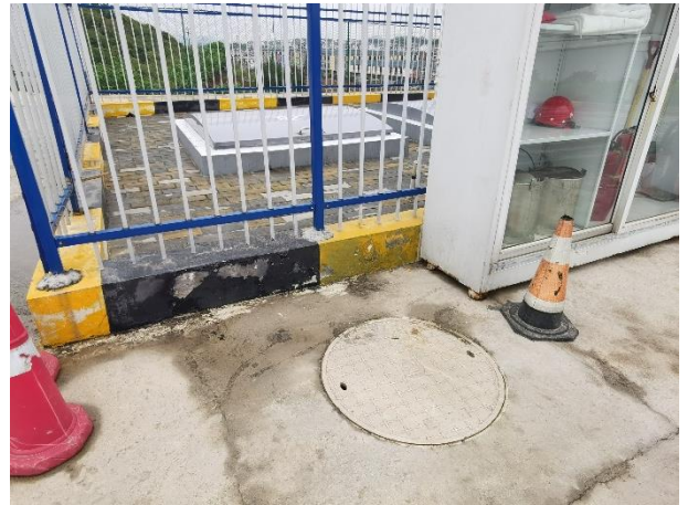
油气回收安装位置
