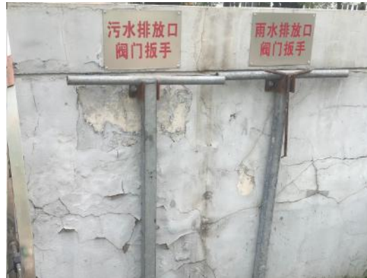
图 4 厂区原有雨污水排放口截止阀扳手
