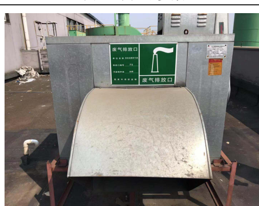
图 4 排放口标识牌
