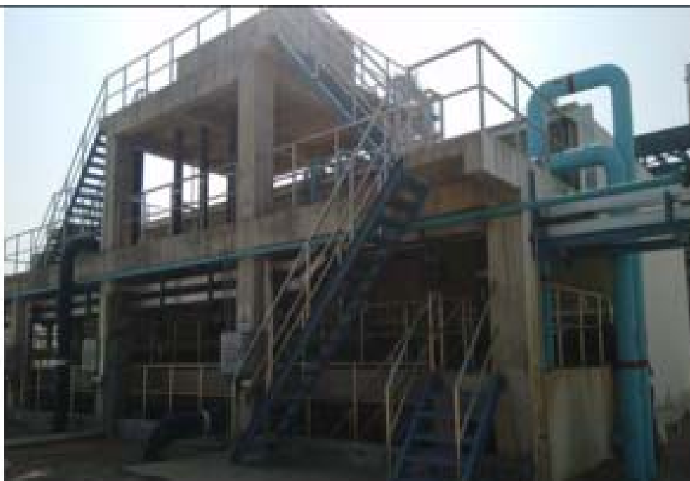
图 4.5 含油污水处理系统---BAF 池
