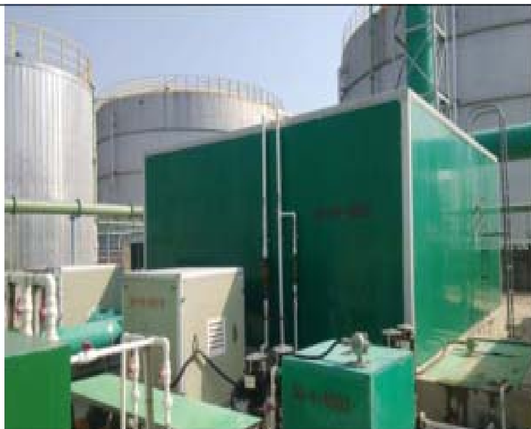
图 4.8 污水处理站除臭装置
