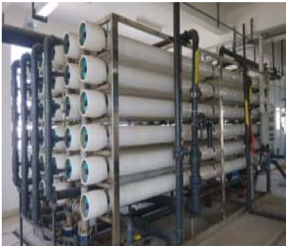
图 4.6 含盐污水处理系统---RO 膜
