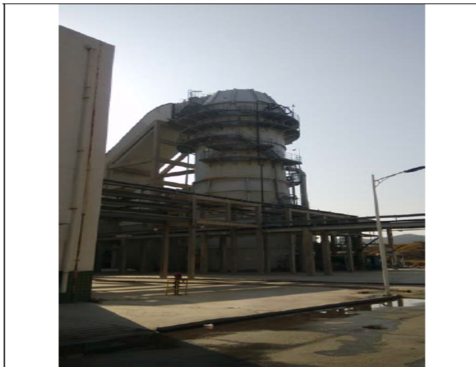
图 4.12 烟气处理—脱硫塔装置
