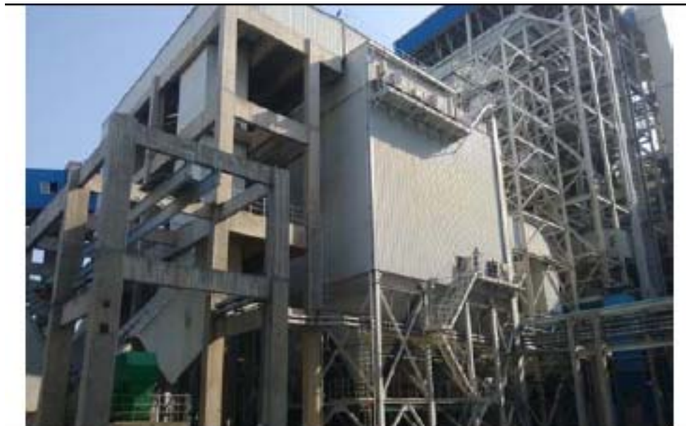
图 4.13 烟气处理—电除尘装置
