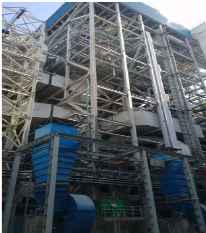
图 4.11 烟气处理—SCR 脱硝装置
