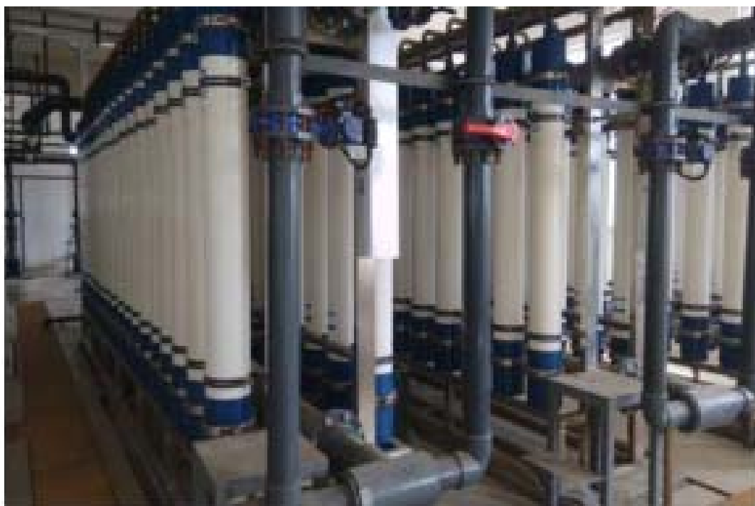
图 4.7 含盐污水处理系统---UF 膜
