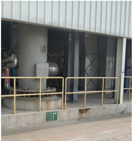
图 4 废气排气筒环保标识牌
