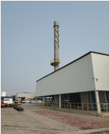
图 3 废气处理设施排气筒 P 1
