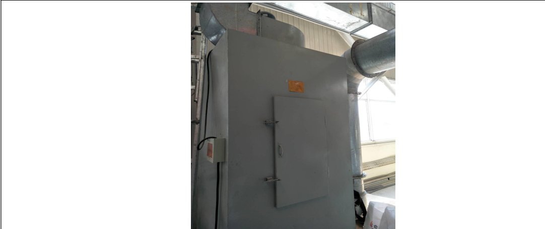
图7 排气筒P 7 对应的除尘设施
