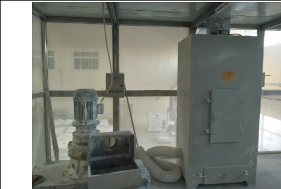
图2 排气筒P 3 对应的除尘器（进气管道为软连接）
